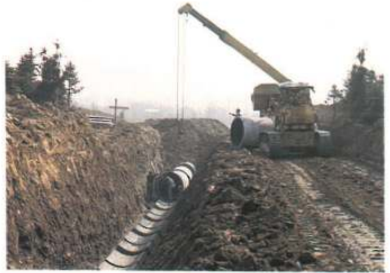
Il collettore della fognatura attraversa i vivai in località cascina Pescarola.
